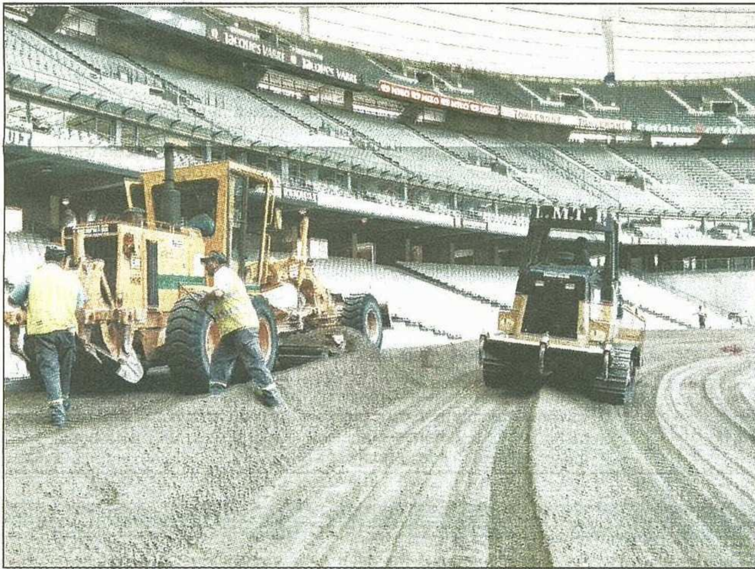
STADE DE FRANCE, HIER. Le chantier dure déjà depuis une semaine : samedi, le stade se transforme en hippodrome pour un show unique au monde, « les Chevaux du Stade - L'Incroyable Pari ». (LP/V.M.D.)
